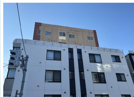
雪庇ガードを設置した当社管理物件
